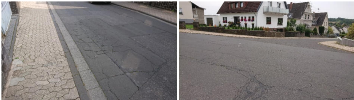
Abbildung 25: Straßenschäden (Kirchstr. (l), Thürer Str. (r))
